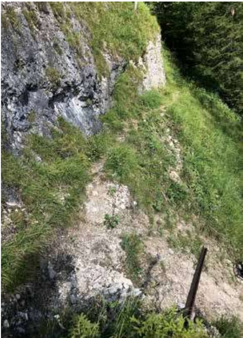
Paindlsteig, hier wäre eine Absicherung durch ein Drahtseil wünschenswert
