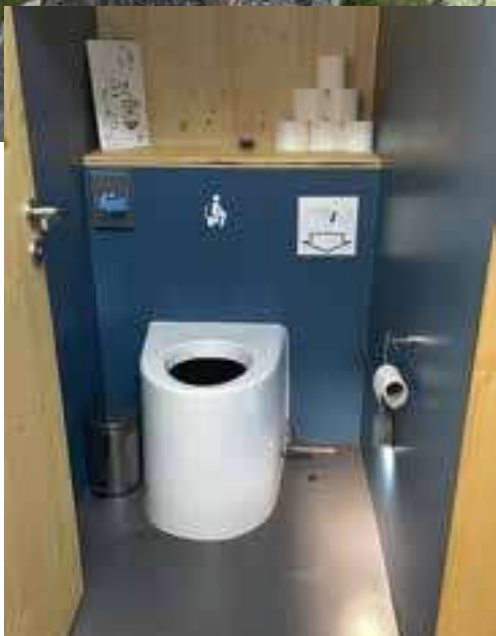
Trocken- trenntoilette in der Hütte
